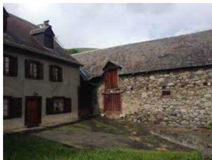
Toiture sans gouttière
